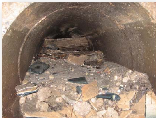
Verfestigte Ablagerungen im Kanal
